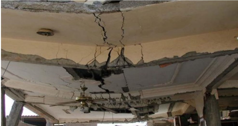
Photo II.5. Fissuration par flexion dans la travée des poutres (Séisme de Boumerdes, Algérie, 2003)
