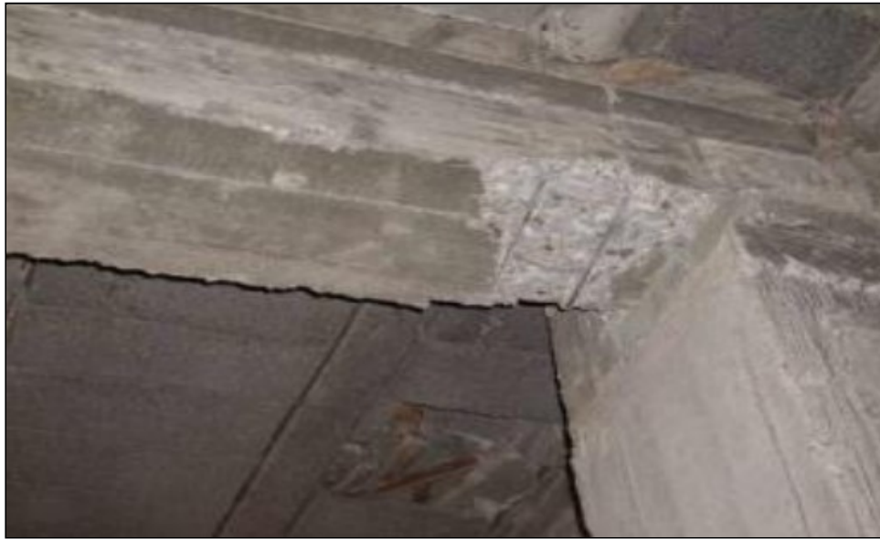
Photo II.6. Fissuration par cisaillement dans la poutre (Séisme de Boumerdes, Algérie, 2003)
