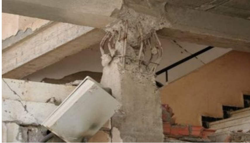
Photo II.3. Flambement des barres et rupture par cisaillement d'un poteau en béton armé (Séisme de Boumerdes, Algérie -2003)
