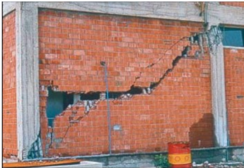
Photo II.4. Cisaillement des poteaux dus à l'interaction avec la maçonnerie
