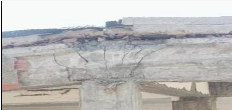
Photo II.7. Rupture par cisaillement d'un nœud en béton armé (Séisme de Boumerdes, Algérie, 2003)
