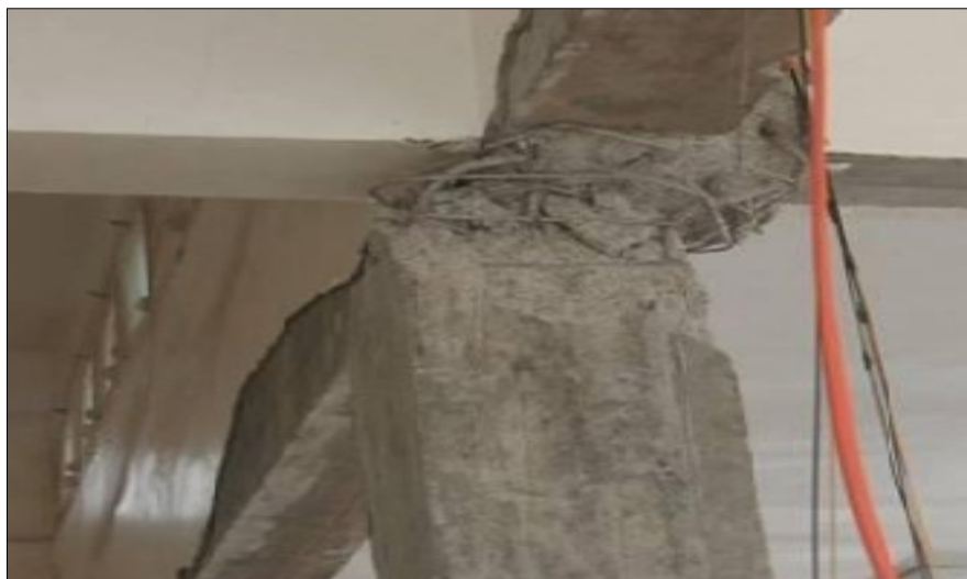
Photo II.2. Ruine d'un poteau court (Séisme de Boumerdes, Algérie, 2003)
