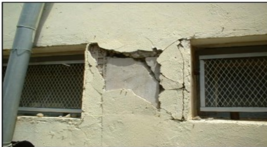
Photo II.1. Les fissures en croix et ruptures par effort tranchant
