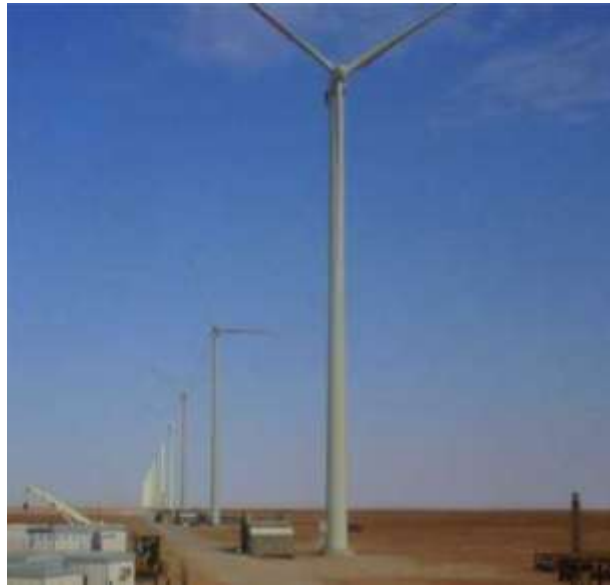
Figure I.8 : La ferme éolienne d'Adrar
