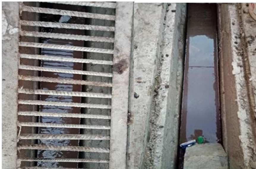
Photos I.11 : Rejet des margines vers le réseau d'égout
