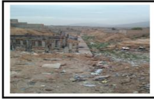
الصورة (03): البناء داخل الواد، وحصر الواد في القناة
