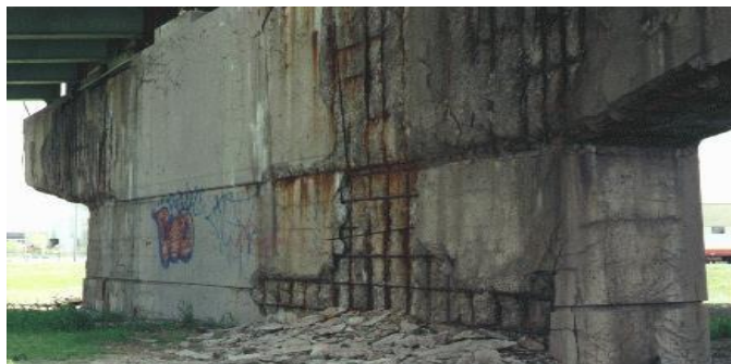
Figure 1.12: Agression du béton par activité des chlorures. [21]
