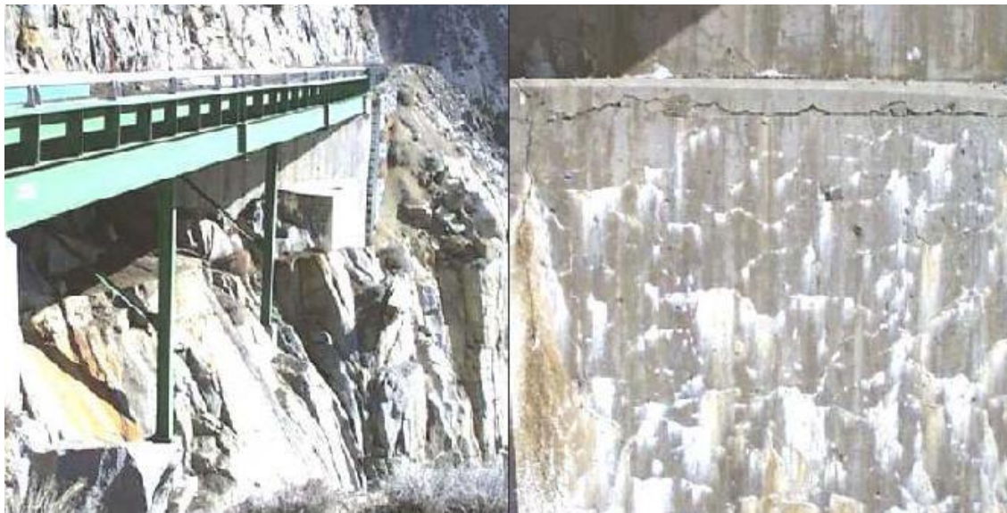
Figure I-6: Des cas pathologiques d'éléments en béton en contact de sulfate.
