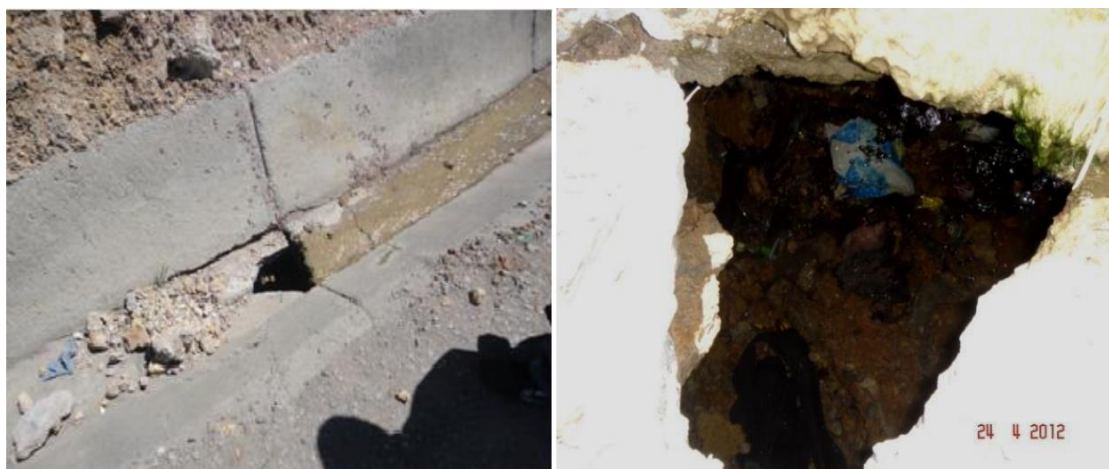
Photo VII.10 : Cavités sous la chaussé due à la dissolution des gypses
