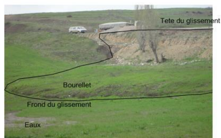
discreption du masse glissée
