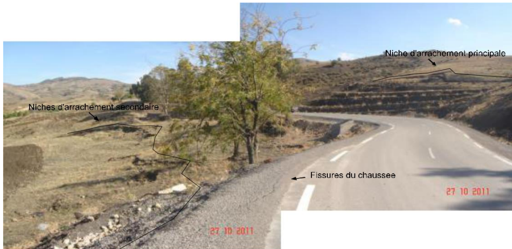
Photos VII.7 : Glissement touchant la nouvelle route
