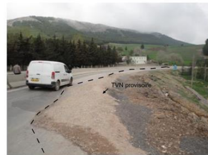
a-couronne du glissement
