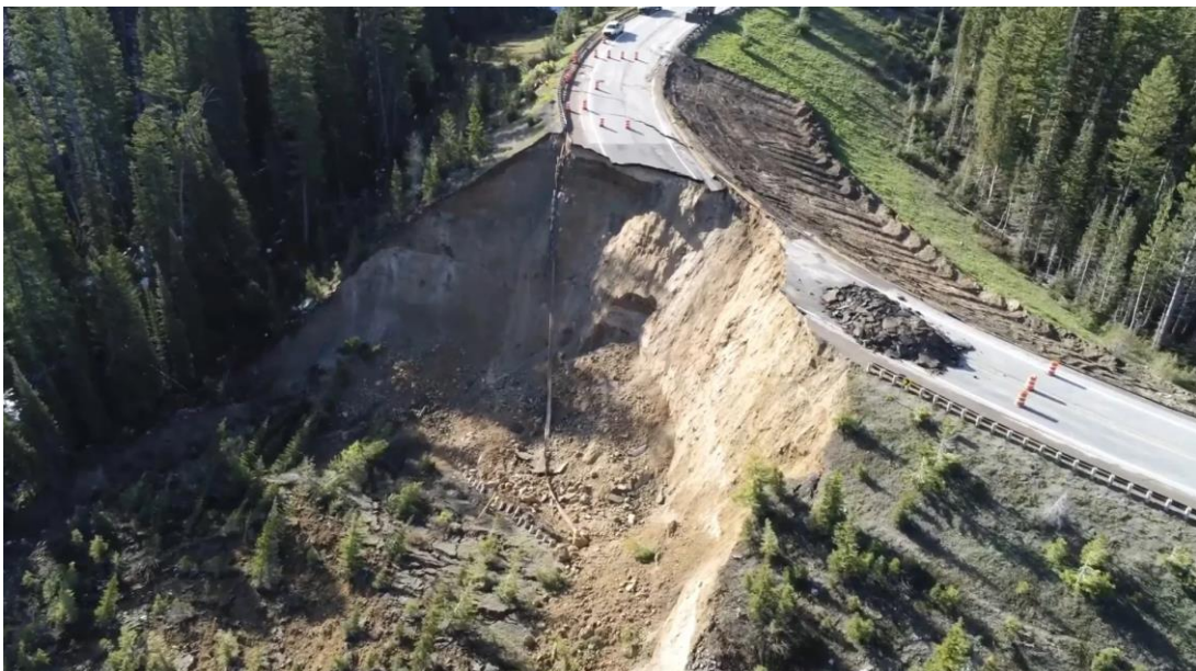
Figure I.2. Glissement de terrain au niveau d'une route
