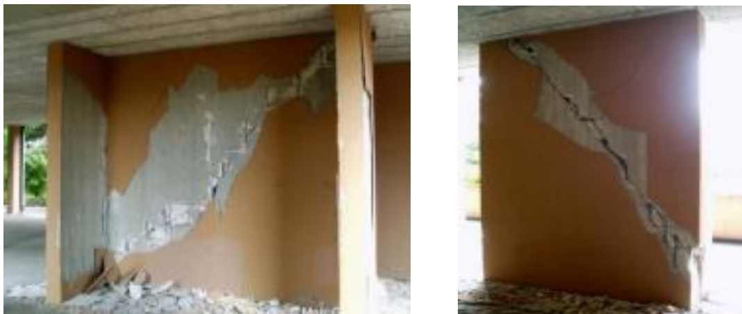
Figure III.4 : Dommages subis par les voiles.
