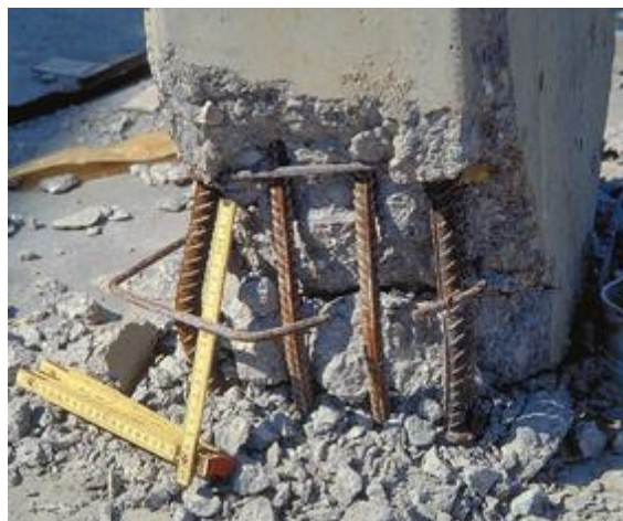
Figure III.9 : Ancrage déficient de l'armature transversale et recouvrement dans les zones Sensible.
