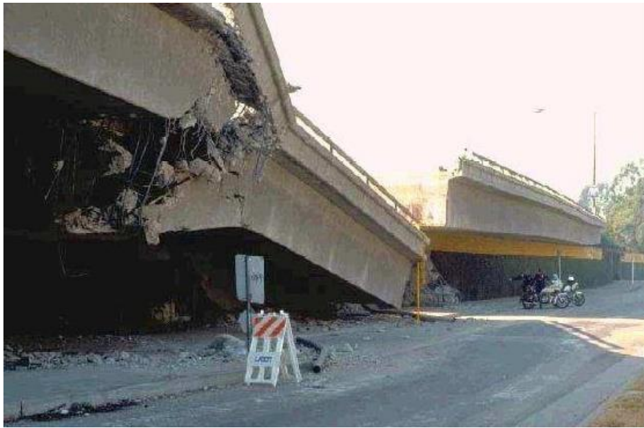
Figure I.17: L'autoroute I-10 de La Cienega Boulevard ruinée malgré la distance et la direction depuis l'épicentre du séisme de Northridge au Californie (1994). La ruine montre l'importance de l'amplification locale de l'énergie sismique.
