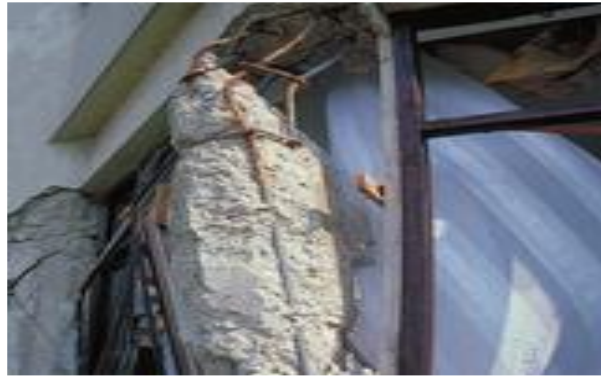
Figure III.10: Flambage de l'armature longitudinale à la base de voile et dans les colonnes.
