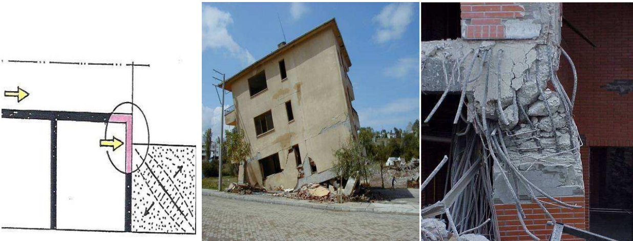
Figure III.8 : Dommages dus à l'effet de poteau court et dû à la présence d'allèges en maçonnerie dans la structure principale en portiques.
