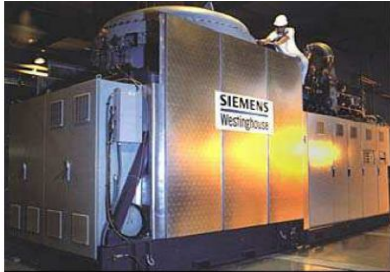
Fig1- 11 : L'installation Siemens-Westinghouse de Irvine (220 kW) (2002)
