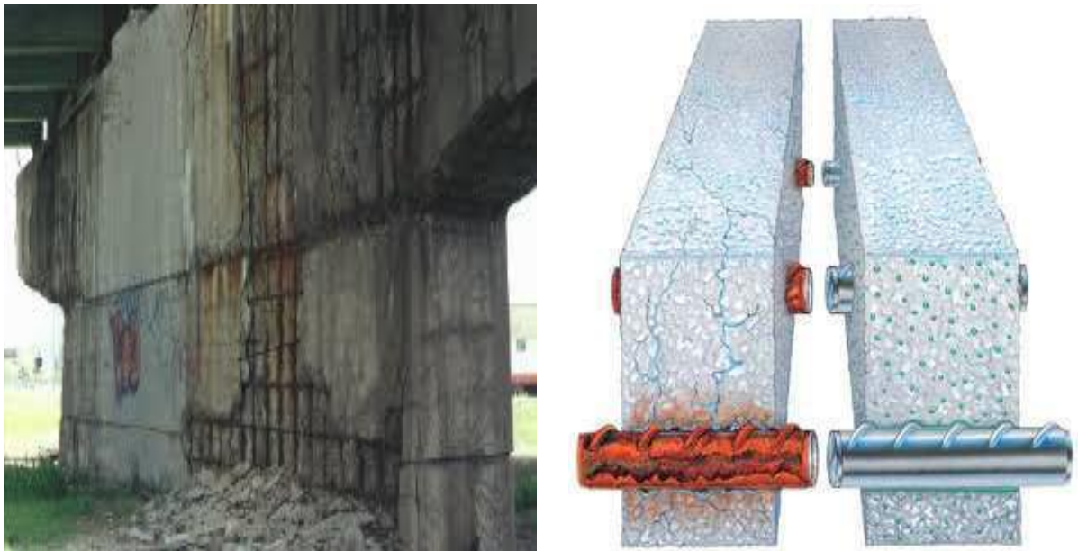
Figure II-13 : Agression du béton par activité des chlorures. [54]
