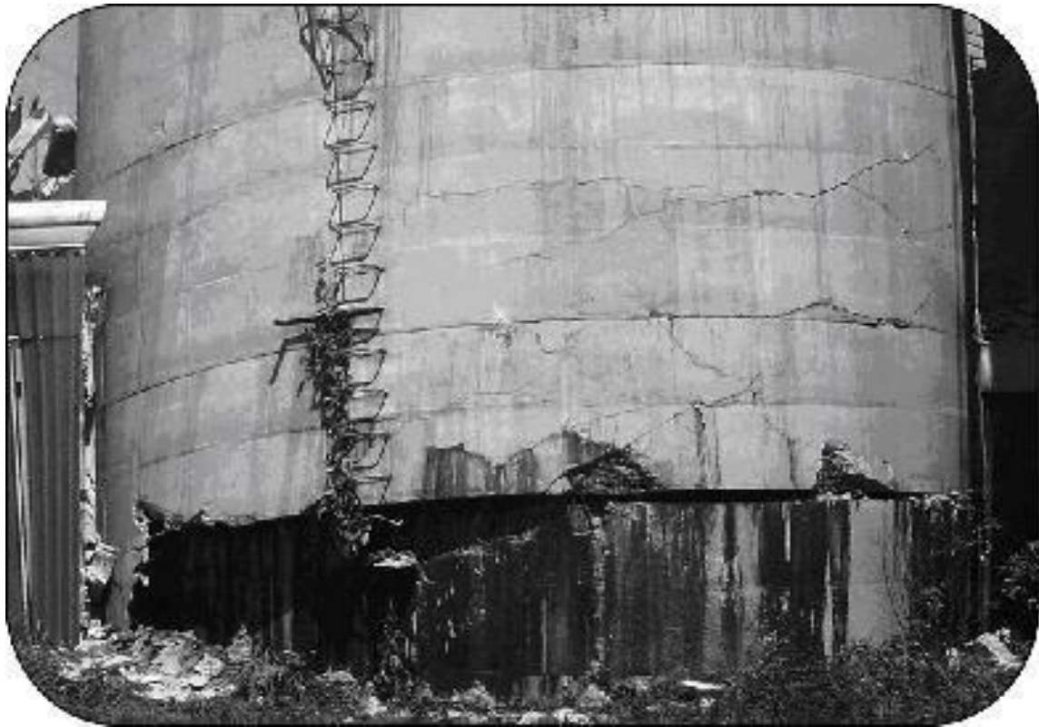
Figure II-11: La détérioration des silos-tours en béton due à l'attaque des acides d'ensilage.
