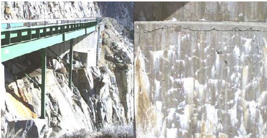
Figure II-3 : Des cas pathologiques d'éléments en béton en contact de sulfate.
