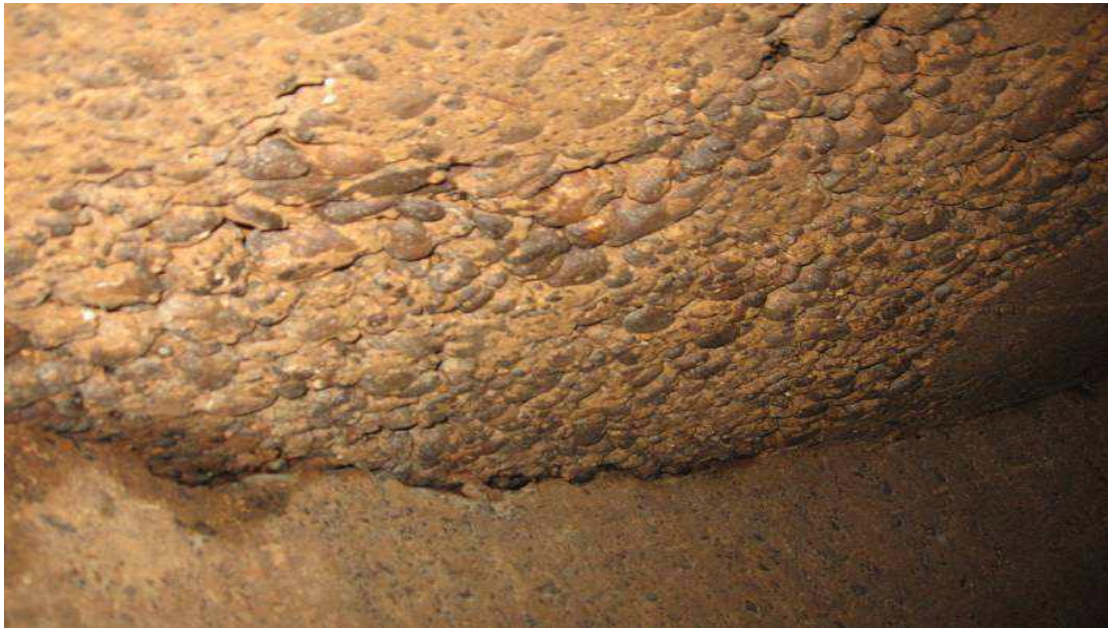
Figure II-17: Lixiviation du béton. [54]
