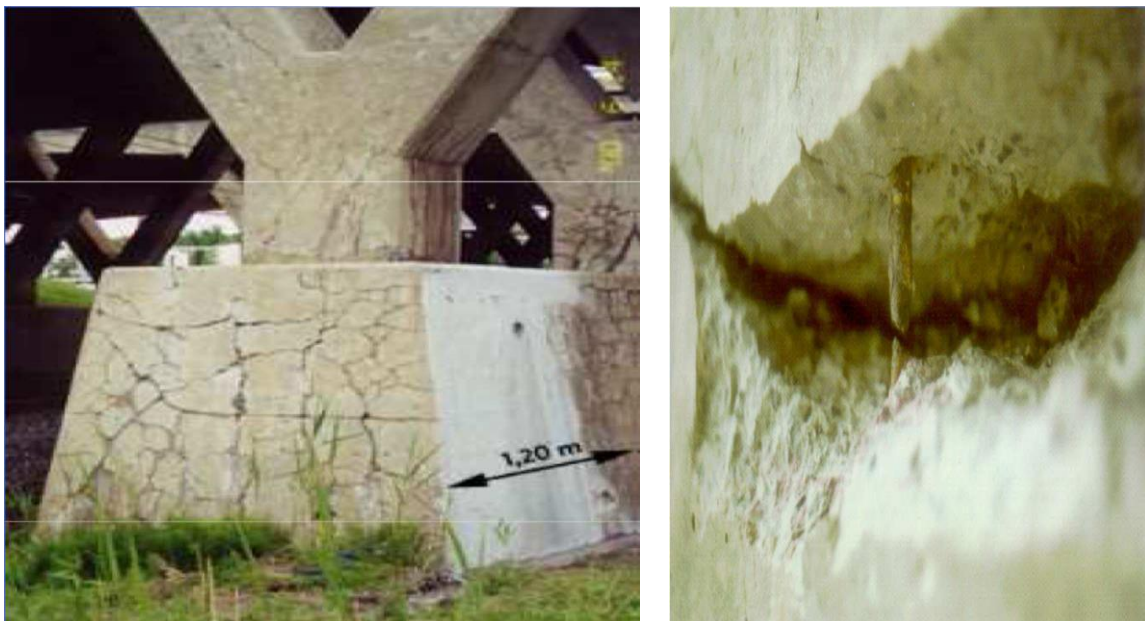
Figure II-15 : Agression du béton par activité des d'alcali-réaction.
