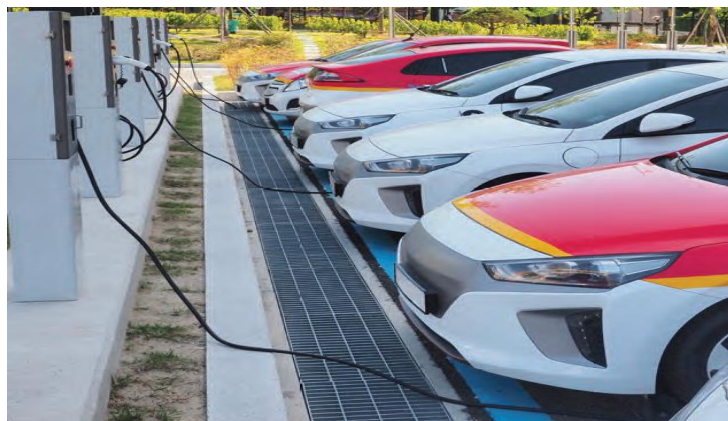
Figure III.6: station de charge électrique.
