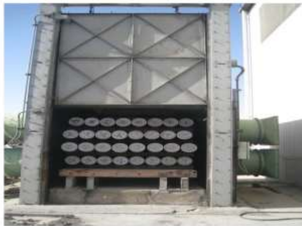
Fig. III. 7 chambre de refroidissement
