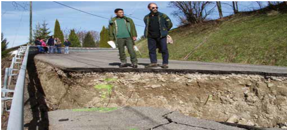
Figure I-1 :Effondrement d'une route suite à un mouvement de terrain
