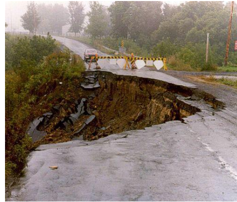
Figure I-6 : glissement rotationnel Rivière Bayonne (Québec.) Canada
