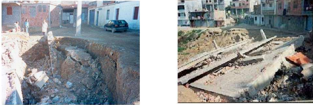
Figure I- 7 : Glissement Smina (BEDJAIA): Vue sur l'escarpement et sur les 3 dalles d'une habitation
