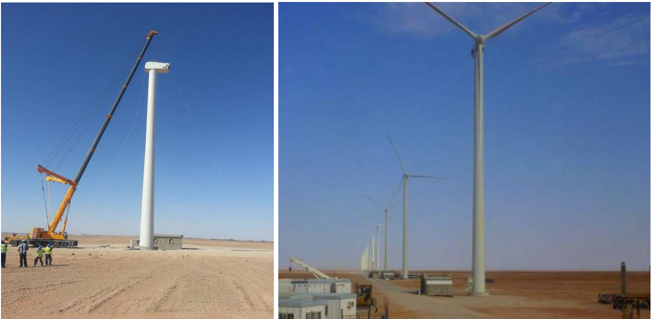
Figure I-4: La ferme éolienne de 10MW à Kabertène (Adrar) [10].
