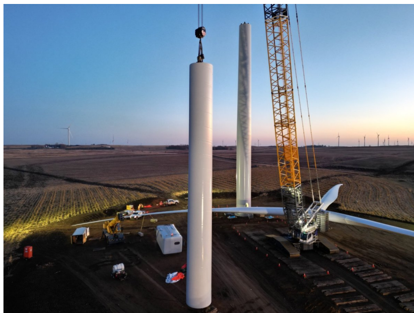
FIGURE 2.19 – Tour d'une éolienne.
