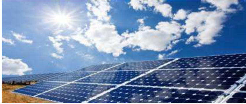
Fig. I. 2 Les panneaux solaires photovoltaïques [2].
