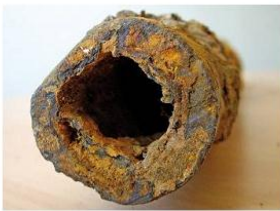
II -Figure 1 -Vieillessement des canalisations.
