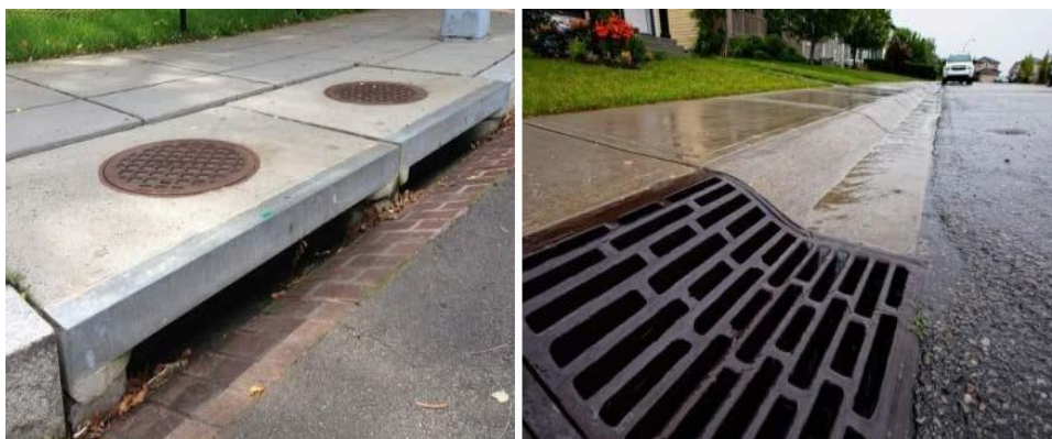
Figure 4.4: Les bouches d'égout (Avaloir)
