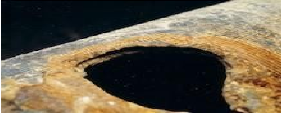
Figure I.12 : Conduite subie une corrosion externe par courant vagabonds [5]
