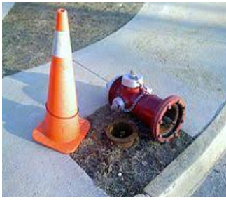
Fig.. III.6. Bouches d'incendie fracturé
