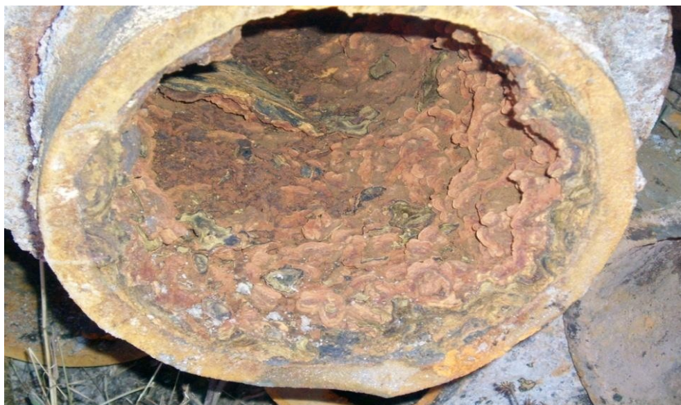
Figure I.1 : Vieillissement des canalisations en fonte [9].
