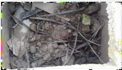
Fig III.1 : Regard de ventouse. (Remblai de Terre est pierre est de déches)
