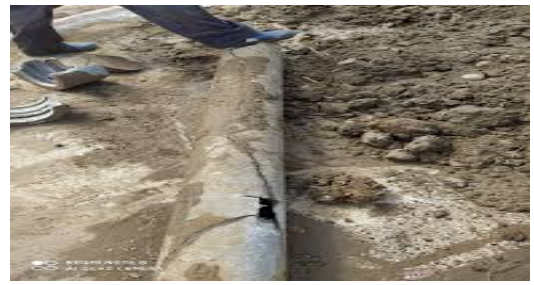
Fig : III.7. Tuyau en A.C fracturée
