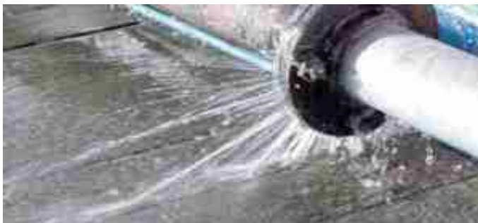
Fig. III.5 : fuites au niveau des joints
