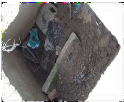
Fig III.3: Tampon n'est pas à ça place de regard
