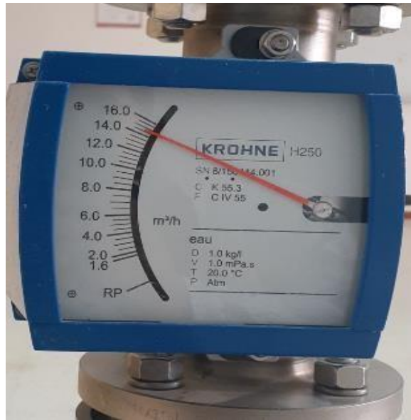
Figure I.5: vue du tube de mesure de débit
