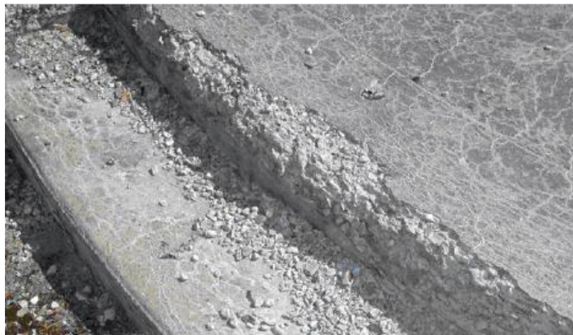
Figure (I-10) : Fissuration interne due par l'action des cycles de gel-dégel, Gayné et al (2008).
