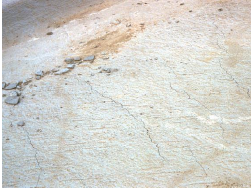
Figure (I-12) : Exemple des fissures provoquées par un retrait plastique
