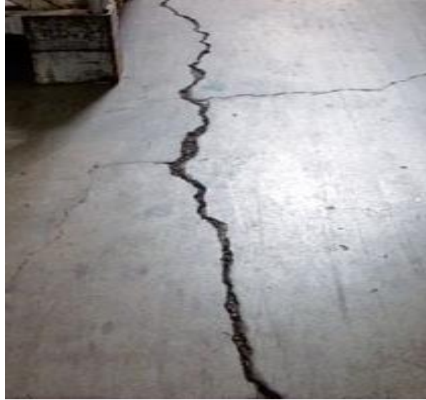
Figure (I-13) ; Exemple d'une fissuration par un retrait empêché
