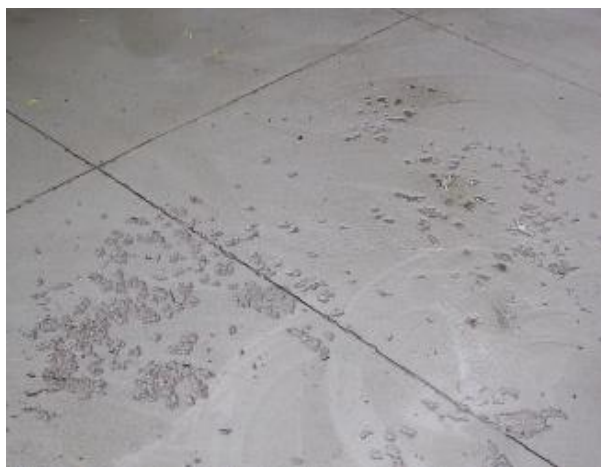
a- Écaillage modéré d'une dalle de béton
