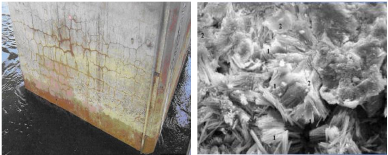
Figure (I-6) : Réseau des fissures dans un pont endommagé par RSI, Divet (2003).
