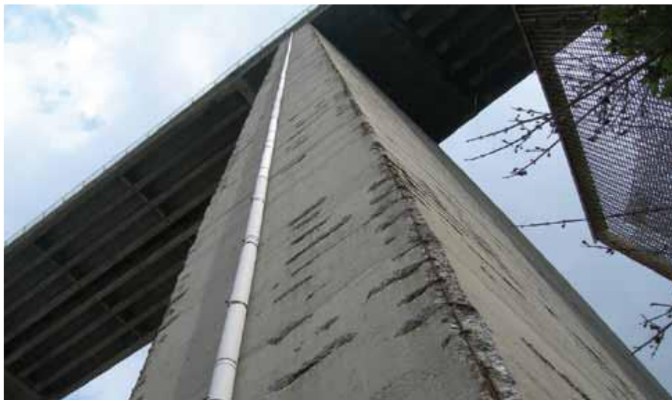
Figure (I-1) : Exemple de fissures causées par la carbonatation.
