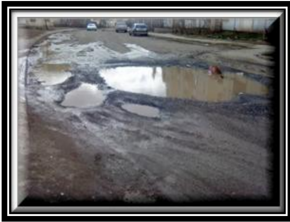
الصورة رقم 88: تسرب للمياه القذرة
