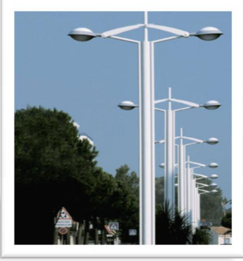
صورة توضح اعمدة الإنارة التي توضع في الطرق والشوارع الرئيسية
