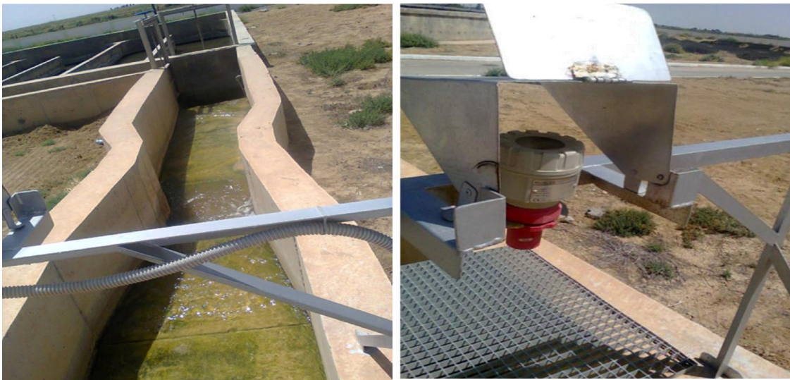
Photo II.10 : Le canal de comptage de sortie.
