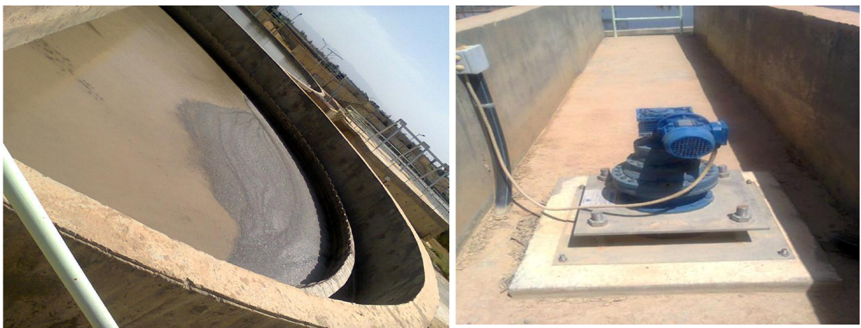
Photo II.12 : L'épaississeur de boues.
