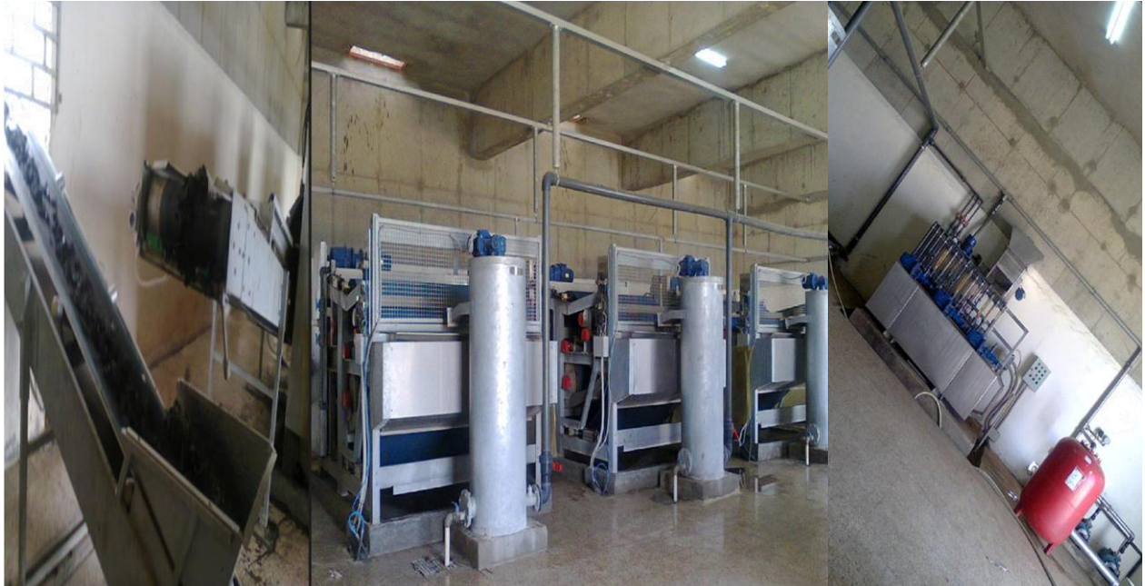
Photo II.13 : système de la déshydratation mécanique.
