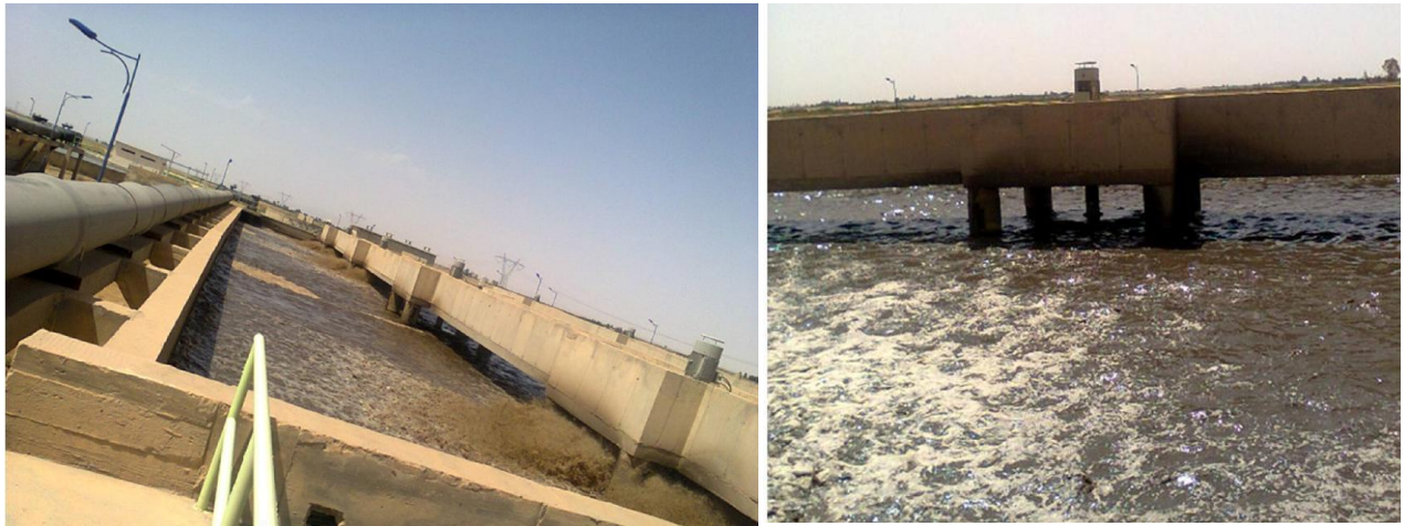
Photo II.8 : Le bassin d'aération.
