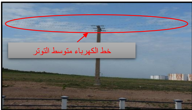
الصورة رقم (18): خط الكهرباء متوسط التوتر
