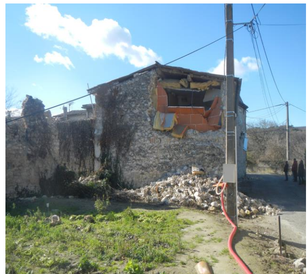
Figure I.4 : Représentation du dommage à une maison du Teil, Quartier de la Rouvière, lors du séisme du 11 novembre 2019 [6].
