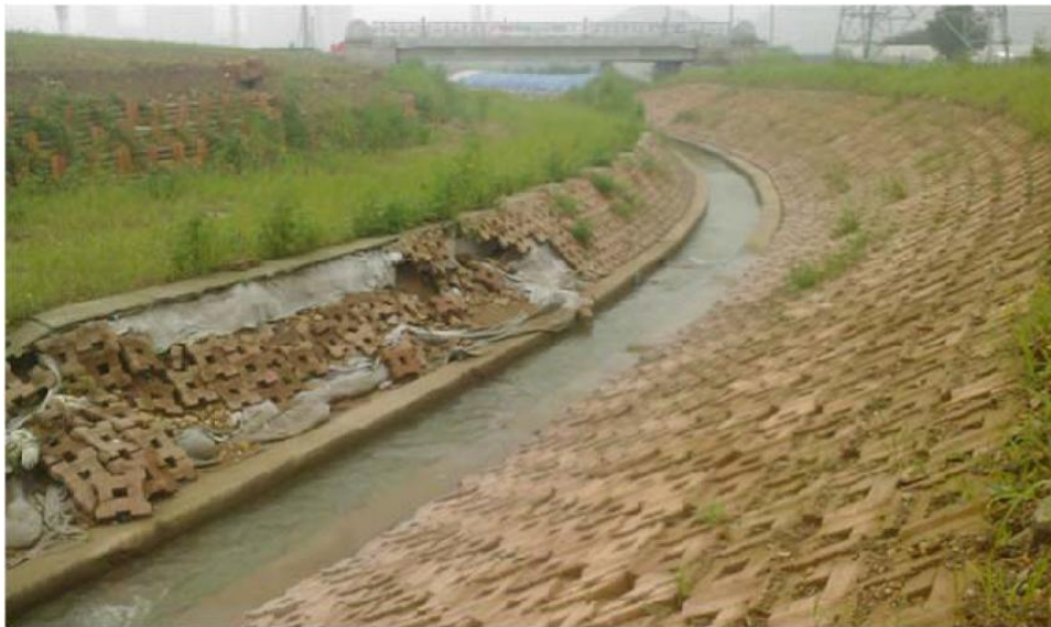
Figure 5.6 : Détérioration des blocs végétalisables
