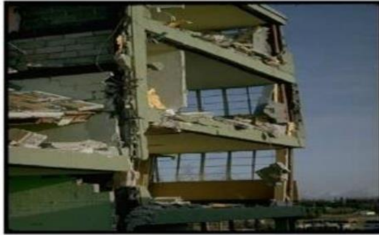
Figure 1.15: Dislocation des remplissages de maçonnerie
