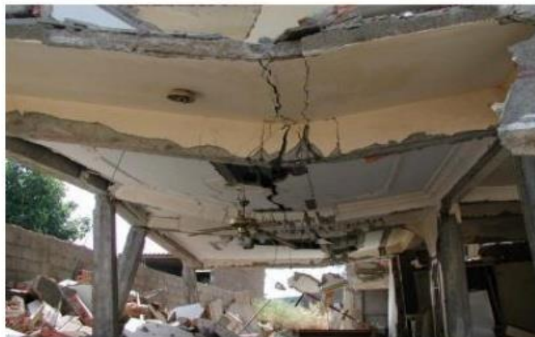
Figure 1.14 : Rupture par flexion des poutres
