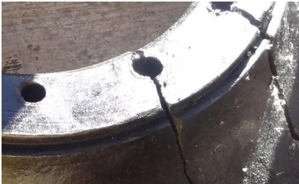
Fig. IV.1 : Rupture brutal du diaphragme
