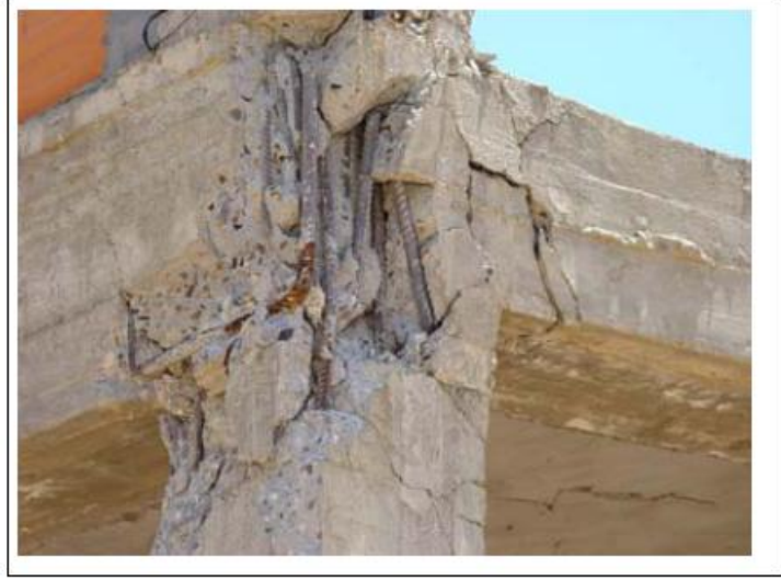
Photo I-6 : endommagement à cause de l'absence d'armatures transversales dans le nœud.
