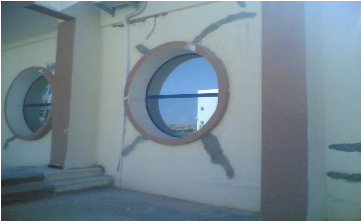
Photo III-2 : Fissures de la maçonnerie au niveau de l'ouverture se forme de diagonale tendue.
