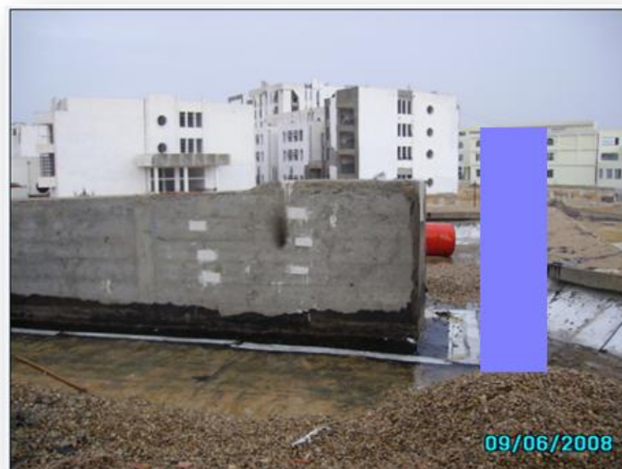
Photo IV-2 : Afin de placer les témoins en plâtre, la poutre a été dérobee de l'étanchéité en pax- alumine.
