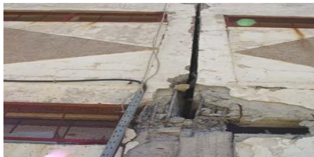
Photo I-4 : Déplacement du joint de dilatation.
