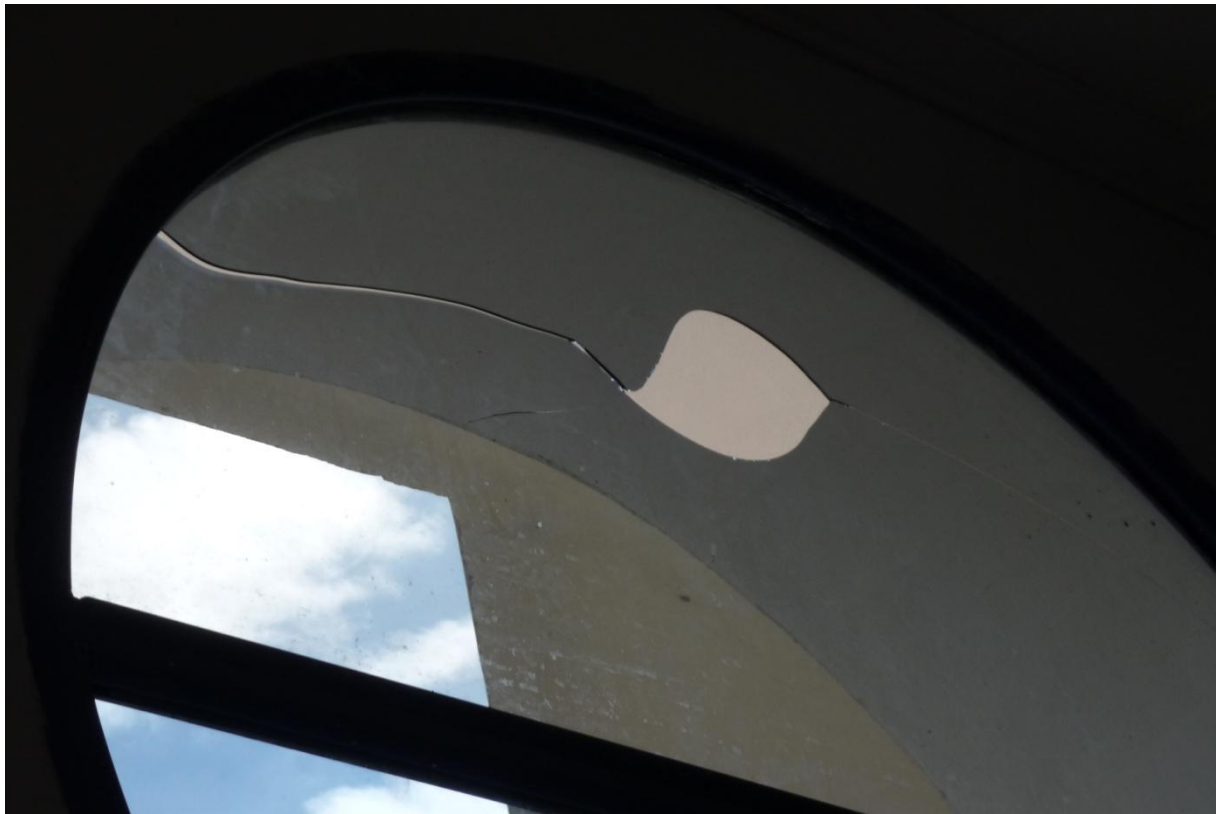
Photo III-1 : Éclatement des vitres.
