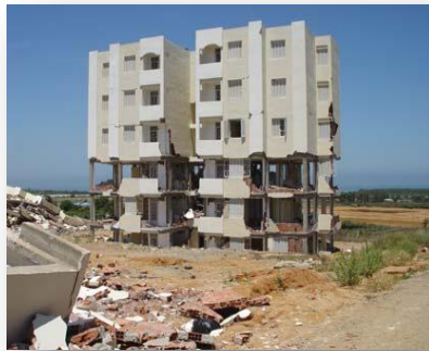
Photo I-1 : l'entaille au centre du bâtiment et sur toute la hauteur.
