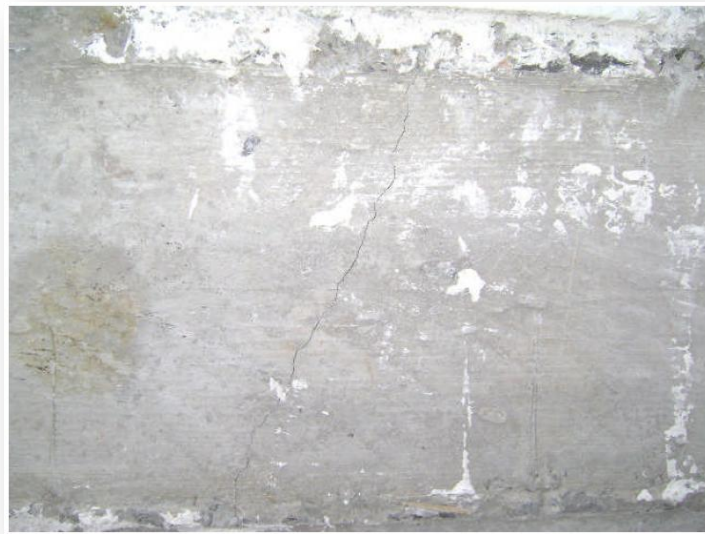
Photo III-7 : Fissure systématique du béton sur la rive gauche.
