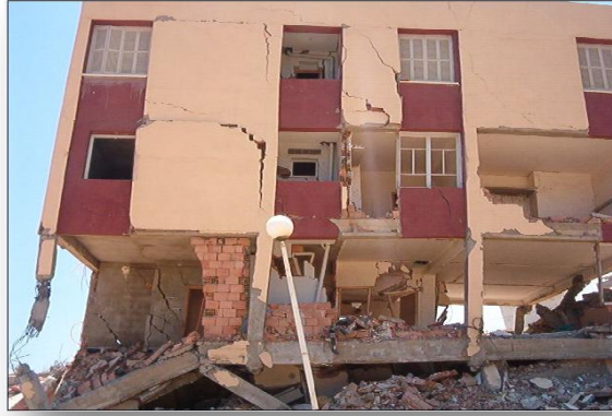
Photo I-3: désordre de multiple étage d'un bâtiment.
