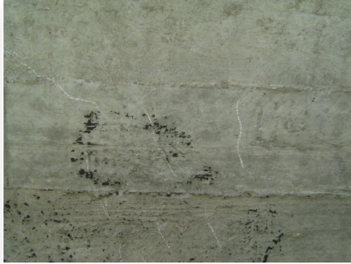
Photo III-6: Marquage des fissures obliques sur l'âme de poutre au niveau de l'appui droit.
