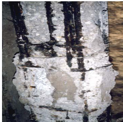
Photo I-7 : corrosion accélérée des amorces poteaux
