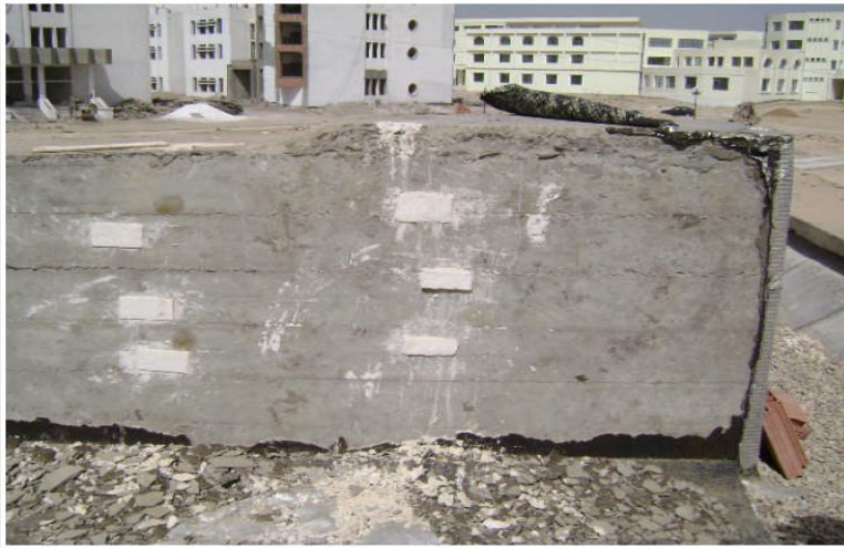
Photo IV-1 : Emplacement des témoins en plâtre
