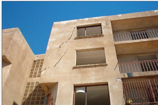
Photo I-2 : fissuration préjudiciable d'un mur de bâtiment.
