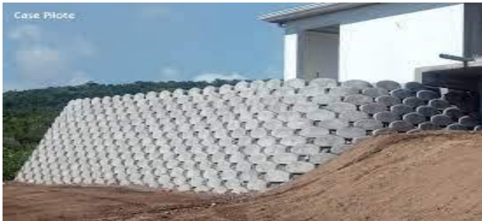
Figure 6.3 : dégâts du bloc en béton
