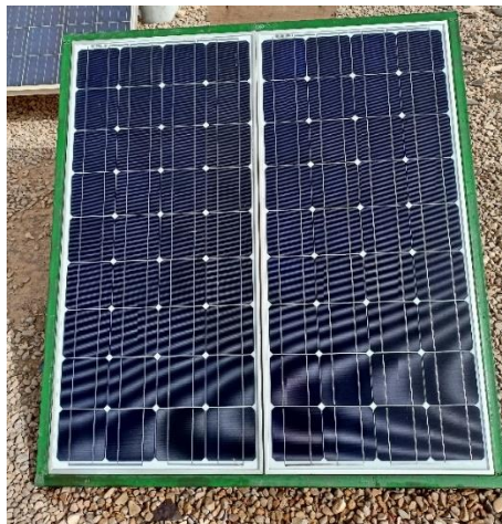
Figure III.7 Les deux panneaux solaires testés (avec et sans nettoyage).
