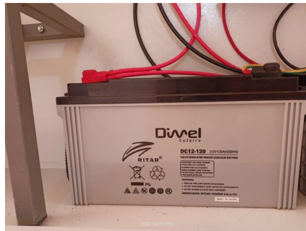
Figure III.16 Batterie ACIDE (12V-120AH/20HR)
