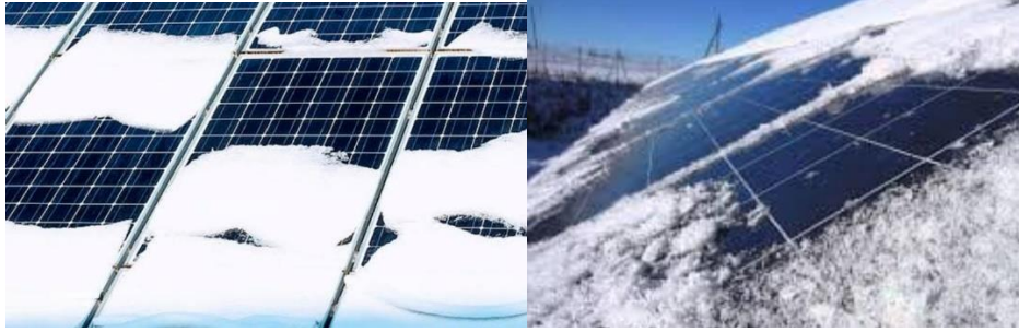
Figure II.2 Le neige sur des panneaux solaires
