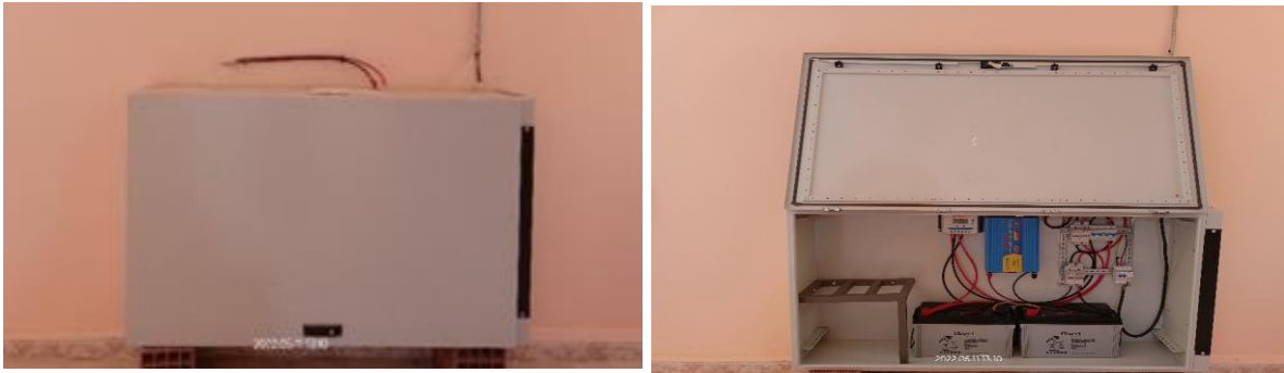
Figure III.19 Armoire électrique photovoltaïque.
