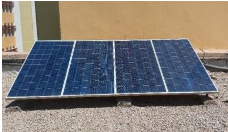
Figure III.15 Quatre panneaux solaires installés sur le toit de laboratoire.
