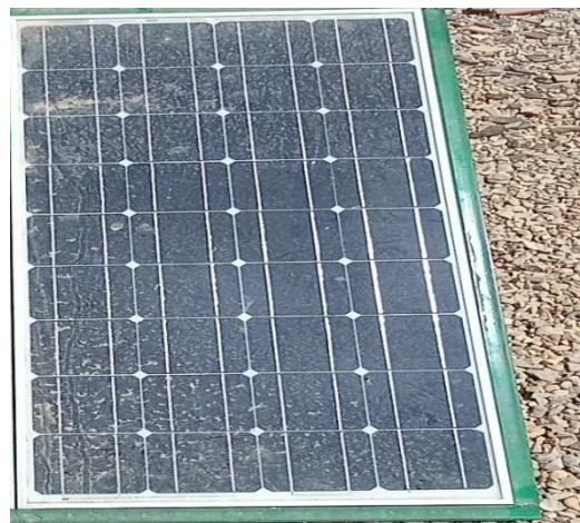
Figure II.3 Panneau solaire en état poussiéreux
