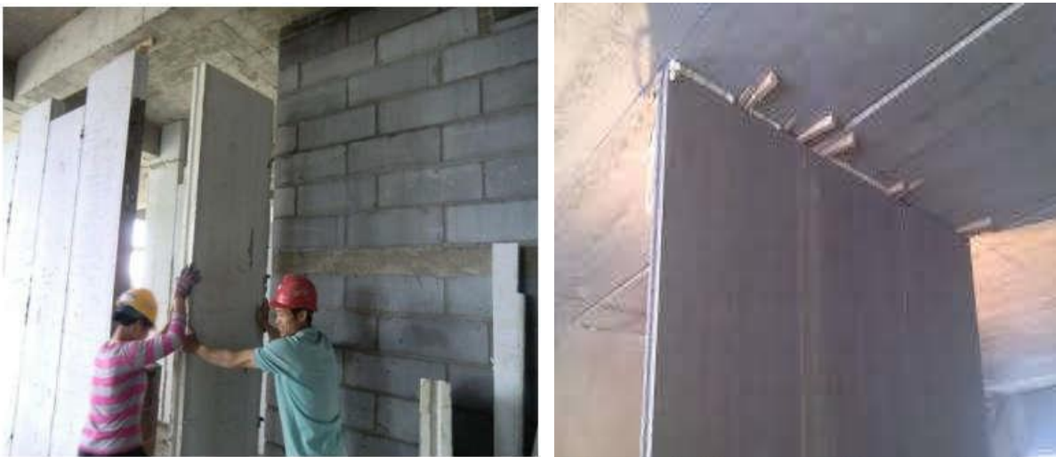
Figure. III.8: Quelques applications de béton polymère pour l'isolation.
