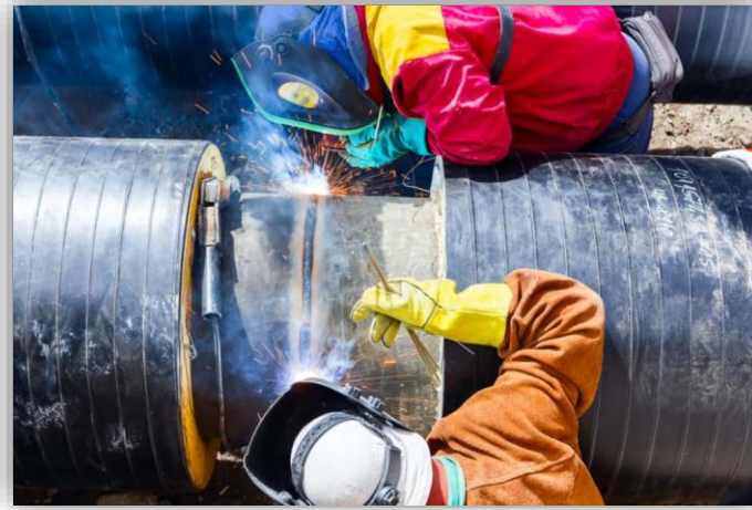
Figure III.3 Recherche de défauts de corrosion au voisinage des soudures de pipeline
