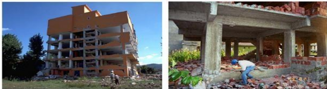
Figure I.5 Ruine et chute des murs de remplissage dans les deux directions épargnant l'effondrement du bâtiment après séisme
