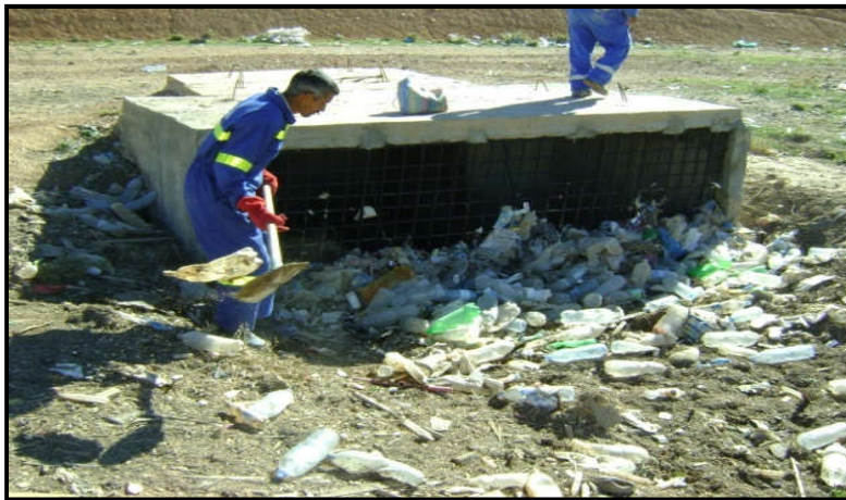
صورة رقم (08) : رمي النفايات في منشآت صرف مياه الفيضان .
