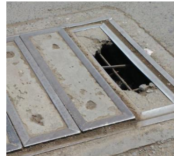
Figure n°169 : regard abimé. Source : Auteur 2017.
