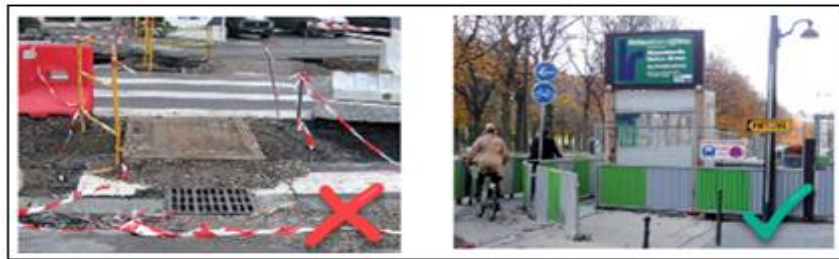
Figure n°34 : Obstacles liés aux travaux de chantier.
