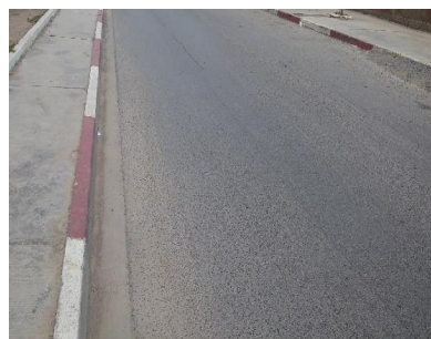
Figure n°189 : état de la route. Source : Auteur 2017.
