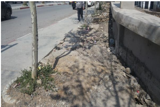
Figure n°192 : Trottoirs trop dégradé. Source : Auteur 2017.
