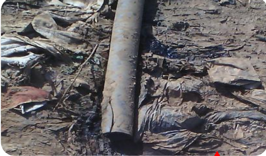
صورة رقم 18: تمثل قنوات الصرف الصحي
