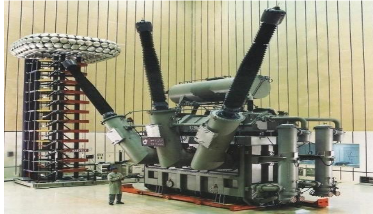
Fig. 1.1 : Transformateur de puissance
