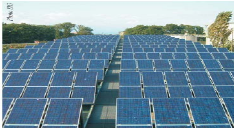
Figure I.20 : Groupement des modules photovoltaïques
