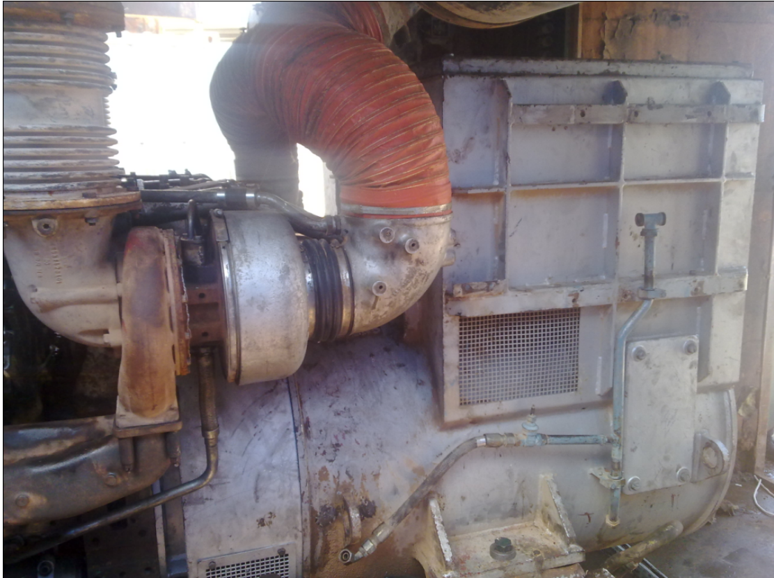
Figure.I.3: Alternateur Siemens 660 kVA
