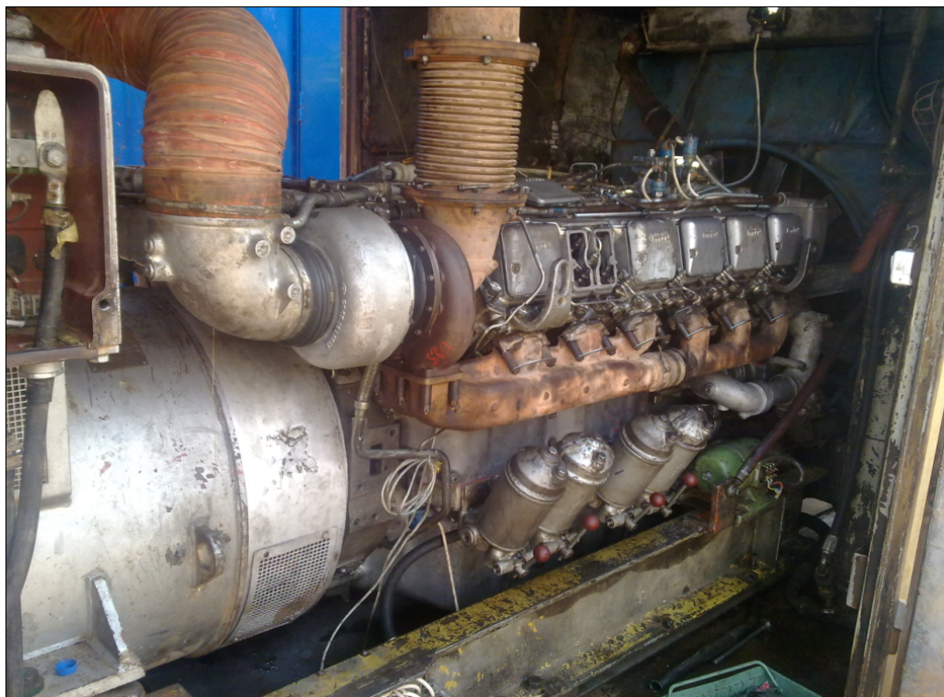
Figure.I.1: groupe électrogène MTU 12V 660kVA
