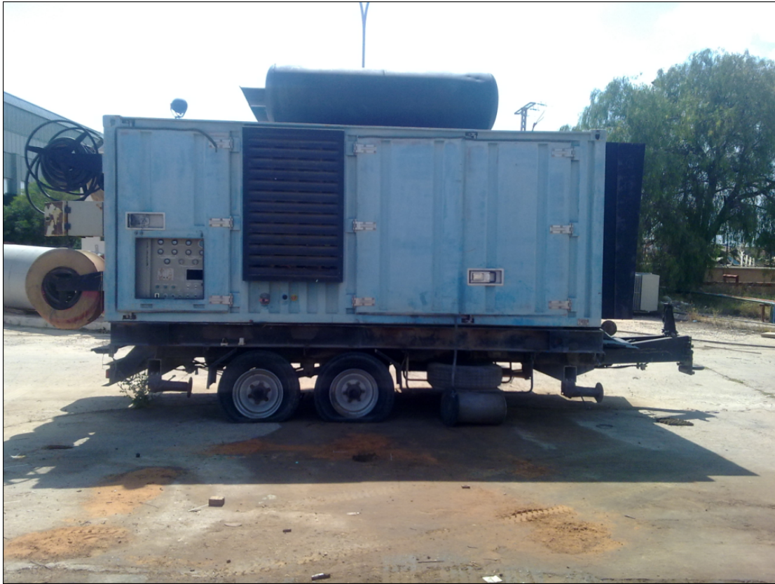
Figure.I.6: Container de groupe électrogène MTU
