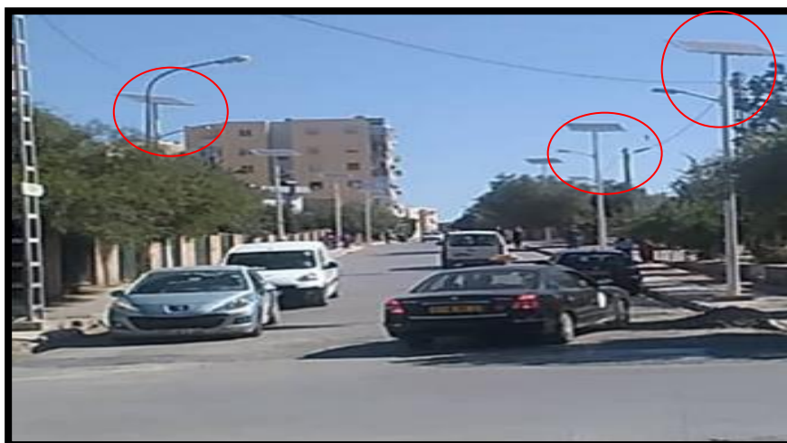
Fig. N 51: Les Poteaux d'éclairage équipé par des panneaux photovoltaïques
