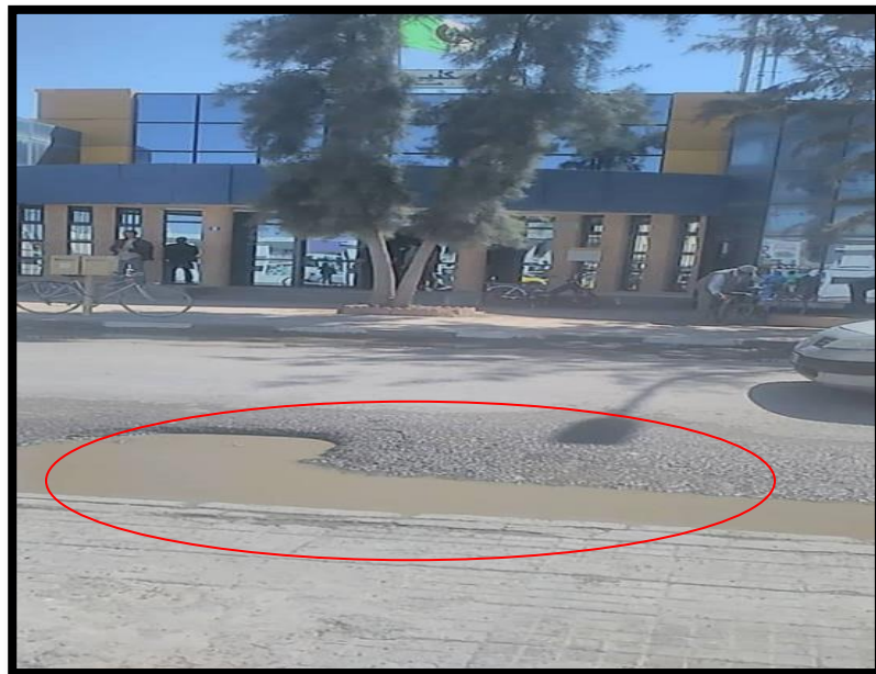
Fig. N 57: Route endommagée car creuser Source : L'étudiant
