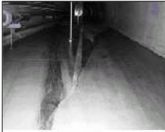
figure I. 28: soulèvement puis dislocation du radier d'un tunnel (A, robert et D, Fabre).
