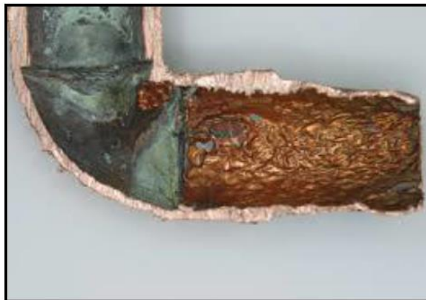
Figure I.2: Corrosion par érosion
