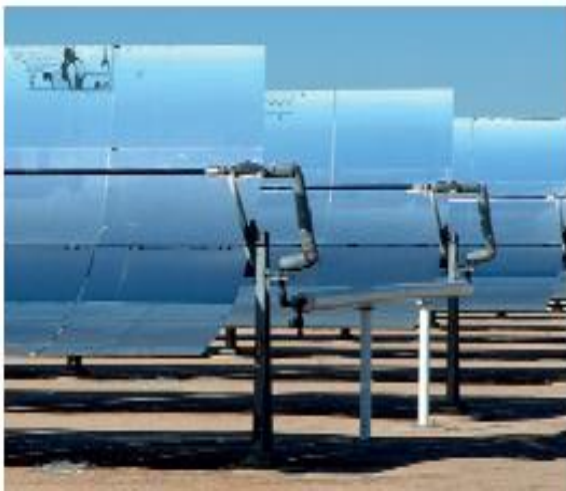
Capteur thermodynamique cylindro-parabolique
