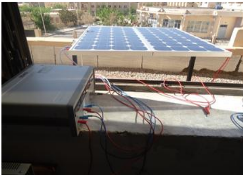
Fig. III.1 : Vue d'ensemble du capteur photovoltaïque.
