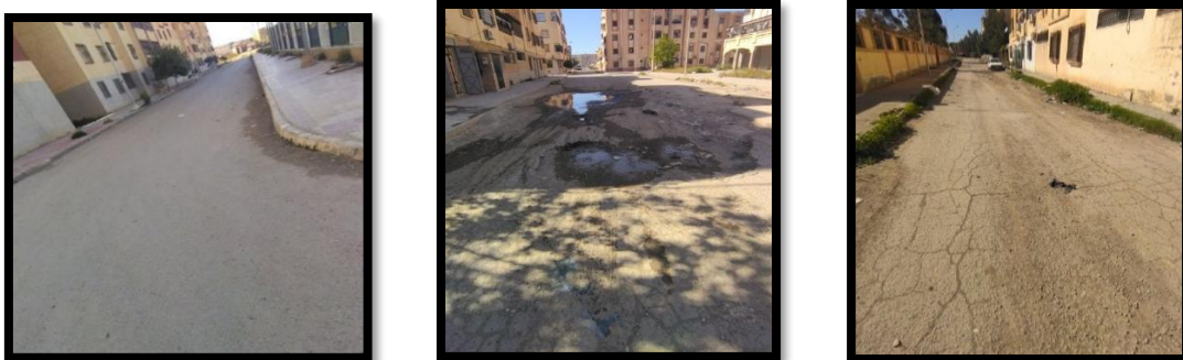
Fig. N06 : des photos d'état des voiries dans la zone d'étude
