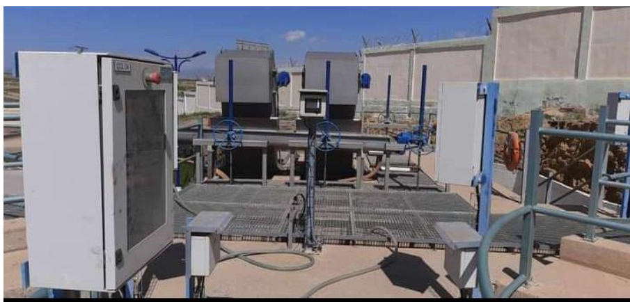
Figure 16. Dégrillage de STEP de « SIDI AISSA ».
