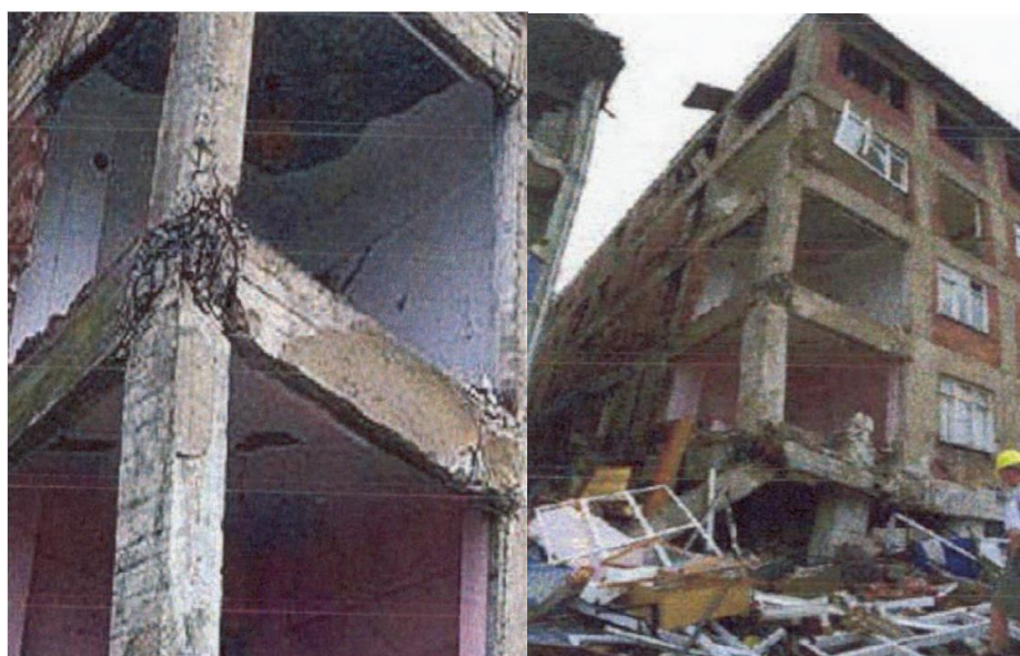
Figure 1.1. Effondrement d'un bâtiment par cisaillement des nœuds poutre-poteau. [3]
