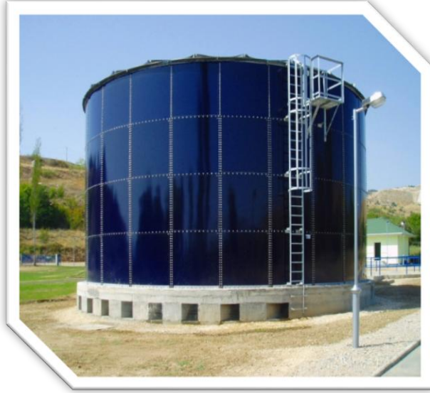
صورة رقم 02: خزان مياه (2000م 3 )
