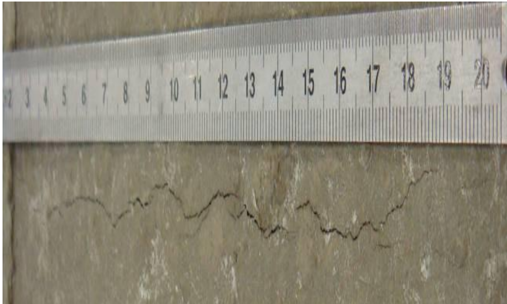
Figure III-8 : Fissure de retrait de plastique.
