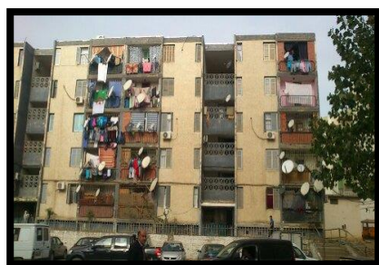
Photo n 10 : façade dégradée par les transformations effectuées par les habitants
