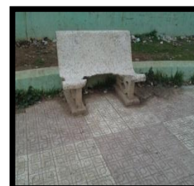
Photo n°36: bancs en ciment détériorée
